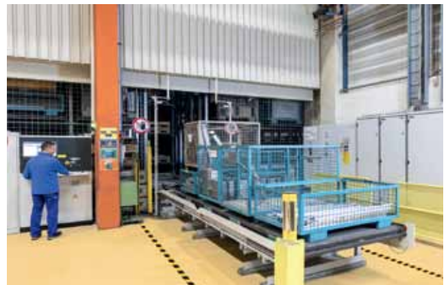
Sensoren überwachen die Einfuhrhöhe der Kassetten.
