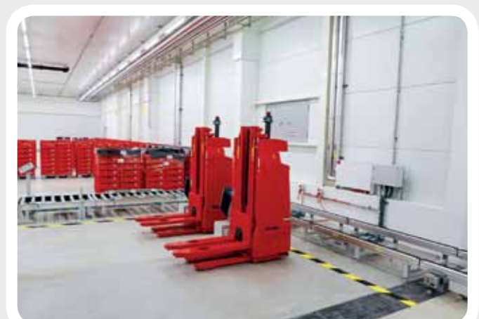
Die vier autonomen Transportfahrzeuge vom Typ „Eagle-Ant 2“ bewegen die Euro-Paletten automatisch zwischen Doppelaufzug und Hochleistungs-Gebinde-Schockfroster (Einlagerstrecke), innerhalb des Pufferlagers sowie zum Kettenhub für die De- und Repalettierung im dritten Obergeschoss.
