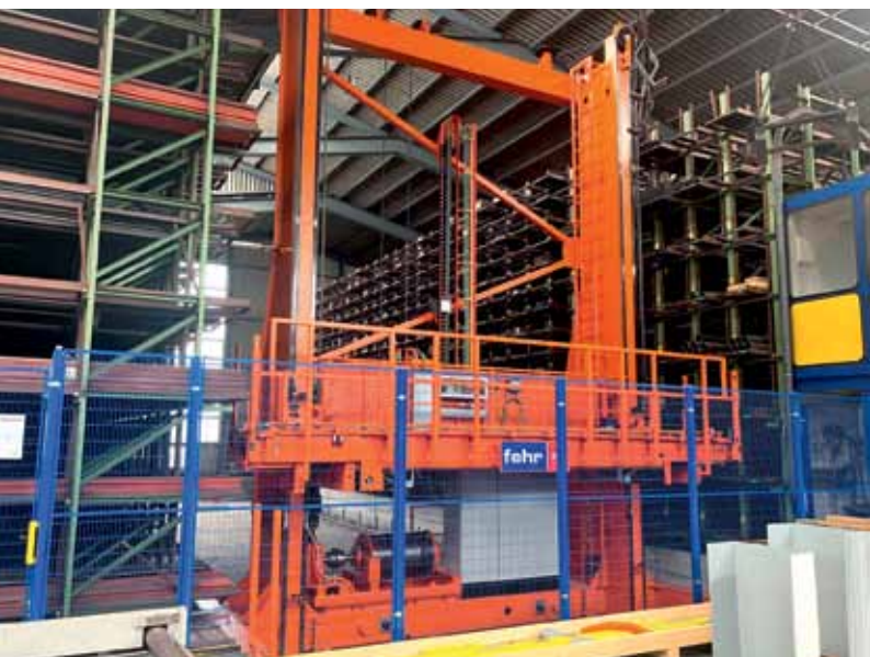
Wabenlager mit neuem Regalbediengerät
