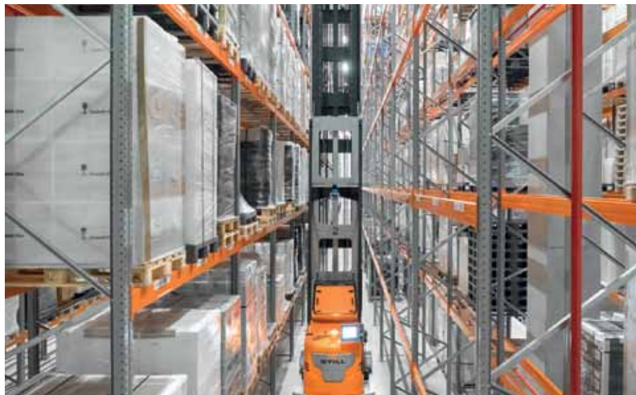
Das Materiallager RVW2 schafft mehr Sicherheit – zum einen zur Sicherstellung der Versorgung der Produktionsstätten und zum anderem angesichts des Fachkräftemangels.
