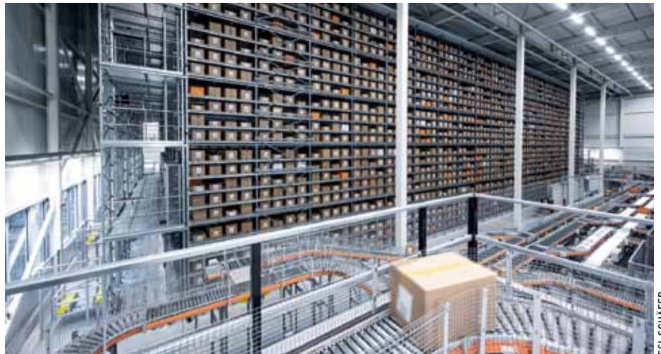
In dem fünfgeschossigen, leistungsstarken Shuttle-Lager entstanden rund 35.000 Behälter- bzw. Kartonstellplätze bei doppeltiefer Lagerung.
