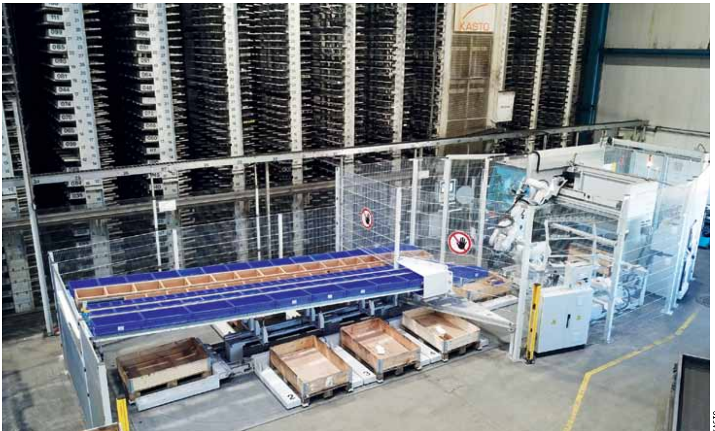
Das österreichische Stahlhandelsunternehmen EHG setzt an seinem Standort Dornbirn auf zwei vollautomatische Sägezellen aus dem Hause Kasto.
