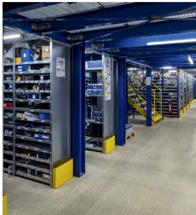
Die neue dreigeschossige Fachbodenregalanlage wurde auf Basis des Regalsystems „Meta Clip“ mit Stahlbaukomponenten realisiert.
