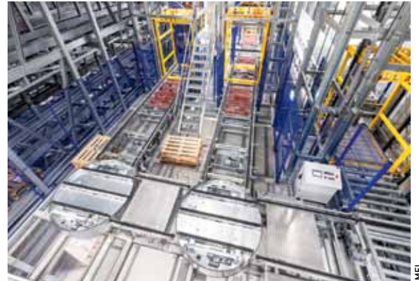
Anbindung der zwölf Ebenen über zwei Einlager- und zwei Auslagerlifte.
