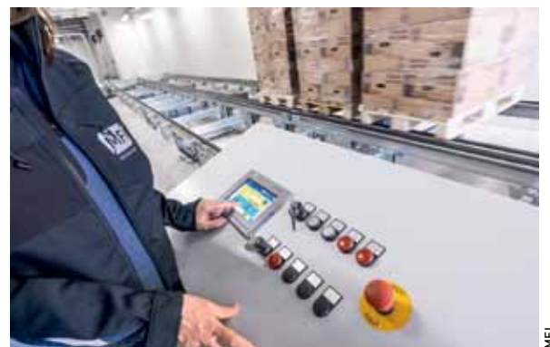
Die Anlagensteuerung erfolgt über die Software „Edy“.
