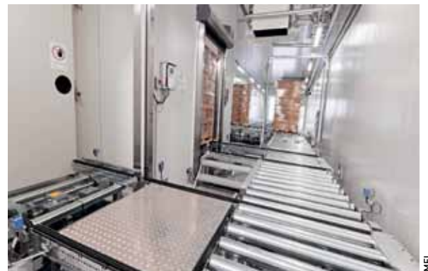
Die Fördertechnik in der Lagervorzone verbindet Wareneingang, Liftsysteme, Versandbereitstellung und das Bestandslager TK 5.
