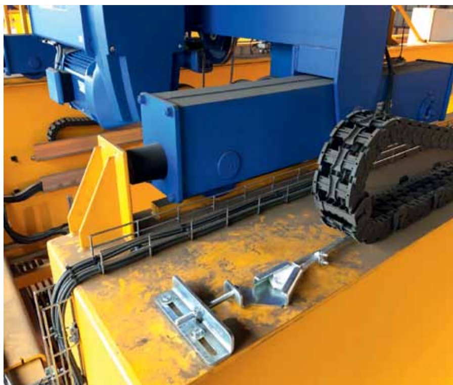
Seil statt Rinne: Das Führungsseil ist auf der Kranbrücke befestigt
