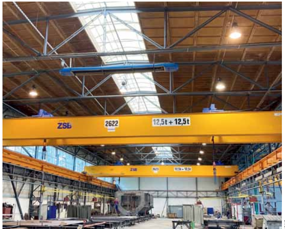
Die beiden Handling-Krane mit 22,5 Metern Brückenlänge und 2 mal 12,5 Tonnen Tragfähigkeit sind als Standardkrane ausgelegt.
