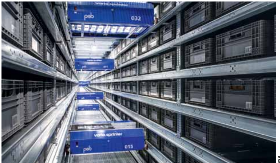
Die „Vario-Sprinter“-Shuttle-Lösung von PSB wird durch das Shuttle-Ladesystem von Vahle in Sekundenschnelle mit Energie versorgt.
