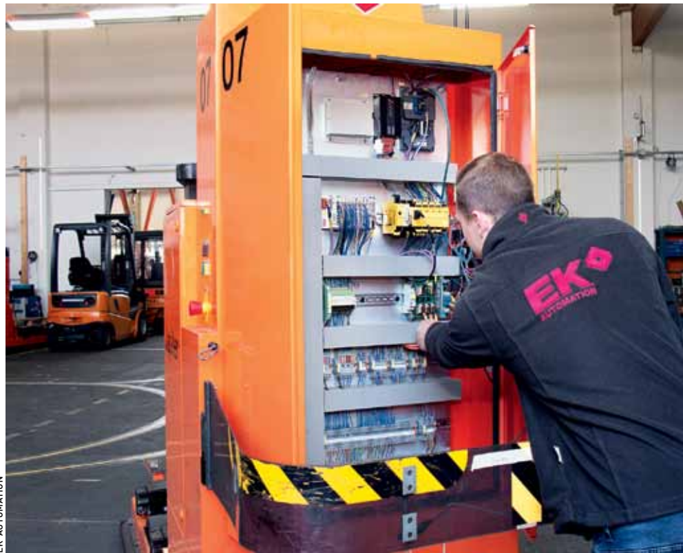
Zentrale Aufgabe beim Refit ist für EK Automation das elektronische Verjüngungsprogramm: Hierbei werden die komplette Fahrzeugsteuerung und die Verkabelung ausgetauscht.
