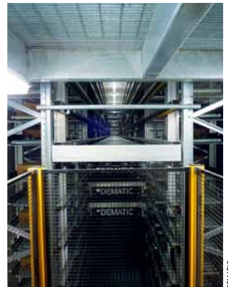
Kompakte und energieeffiziente Tiefkühl-Lagerung mit dem Dematic-Multishuttle.
