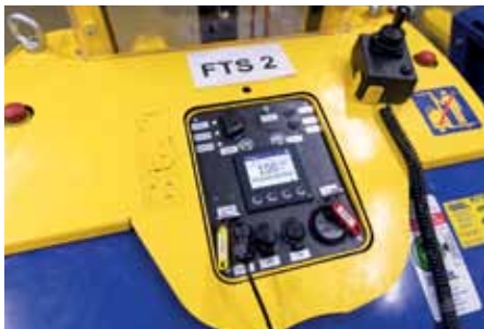
Das FTS ist mit modernsten, sparsamen und wartungsfreien Lithium-Ionen-Batterien von Stöcklin bestückt.
